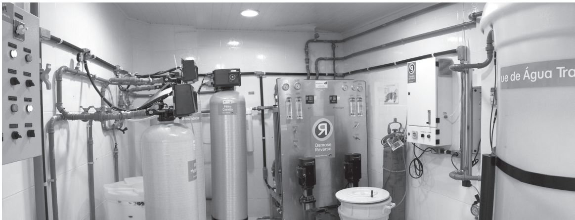
Sistema de tratamento de água por osmose reversa (Foto: Hospital do Rim e Hipertensão - Fundação Oswaldo Ramos)
