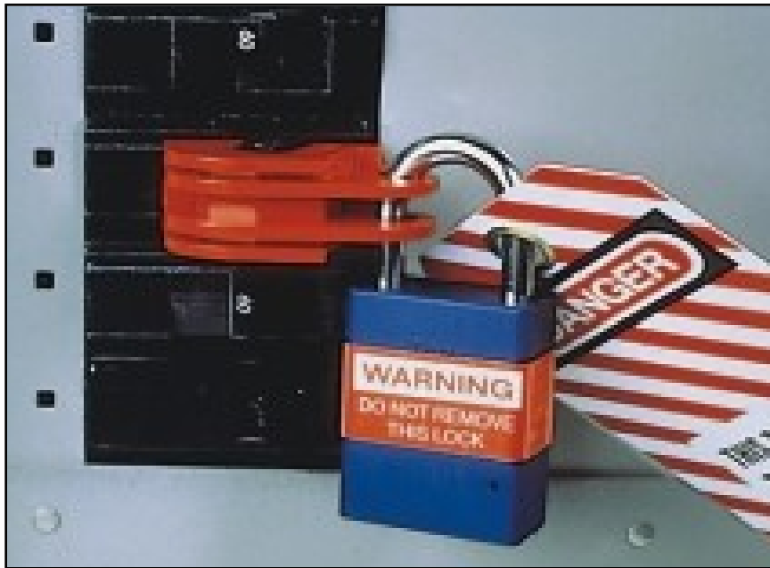
Bloqueio do disjuntor “lock out & tag out”
