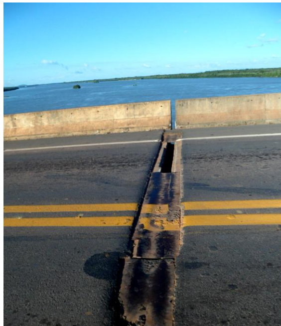
Figura 18 – Afastamento entre duas partes da ponte oferece perigo aos motoristas e requer ação do DNIT.
